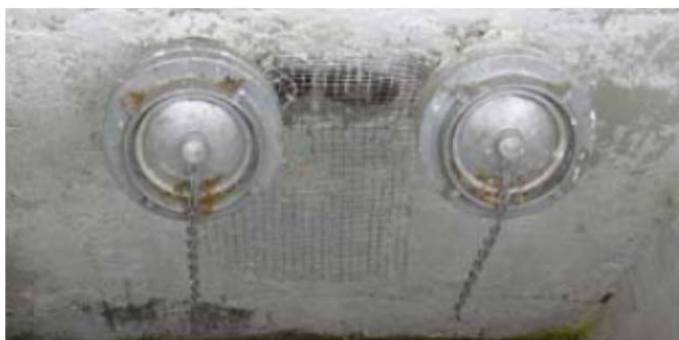
Fig. 6. Toberas de carga neumática del silo (Foto IDAE)
